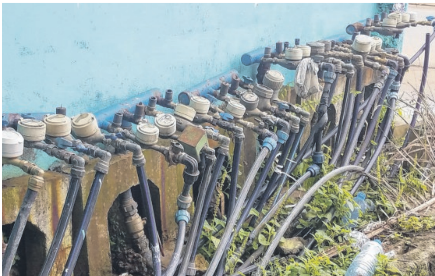
Des compteurs d'eau exposés au vol.
